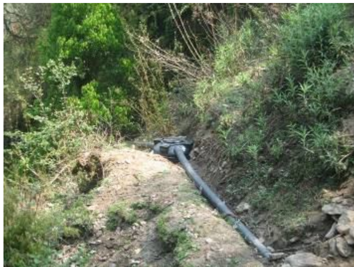
Wasserauffangtank und Rohre
